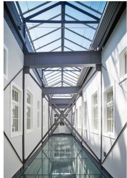
17 Oberlichter leiten Tageslicht ins Innere. Der Brandschutz verlangte eine zusätzliche Glasabdeckung.
